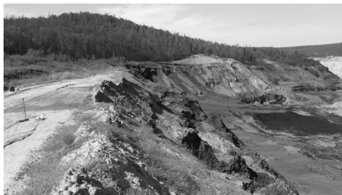
Рис. 6. Разрушение южного борта дамбы в августе 2018 г. Фото предоставлено ведущим инженером ИГДС СО РАН Д. С. Козловым
