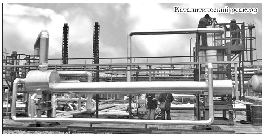
Рис. 4. Внешний вид промышленной установки очистки ПНГ с использованием процесса прямого каталитического окисления.
